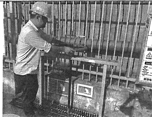
6. 邱員確認廠區雨排水總閥是否關閉。避免產生廢水排出廠外，污染環境。
