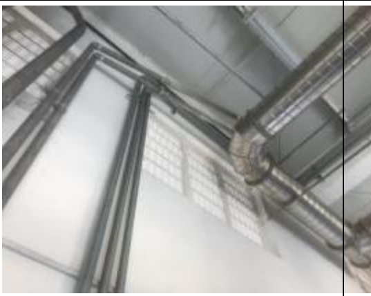
呼吸阀收集废气并入现有废气收集管道
