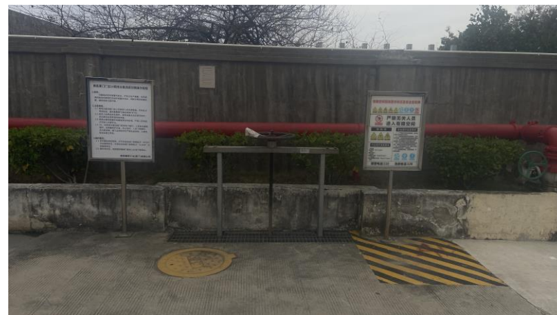
1#雨水总排口阀门
