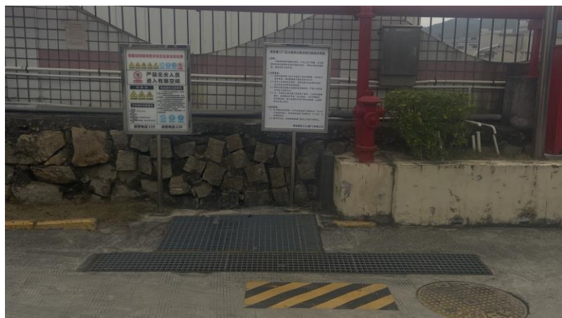
2#雨水总排口阀门
