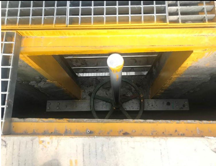
雨水总排口阀门
