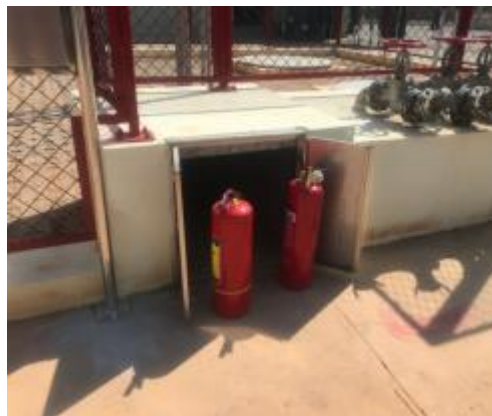
胶水罐区配备消防器材
