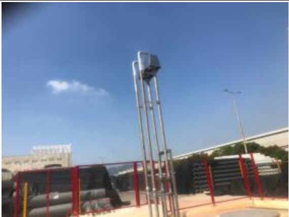
胶水罐区呼吸阀收集罩
