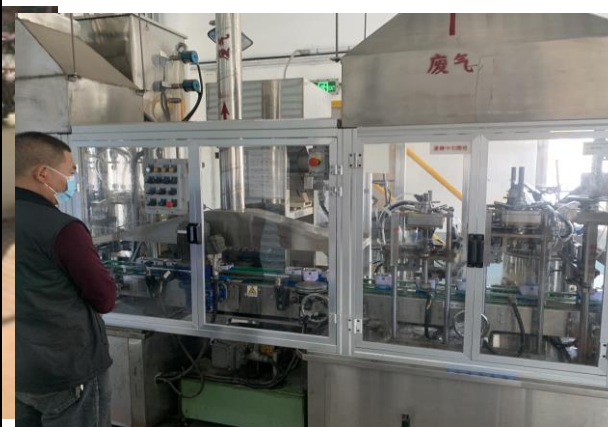
灌胶车间废气收集设施
