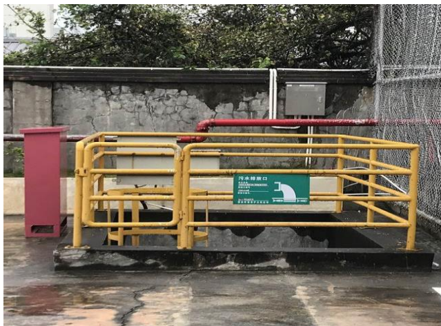
生活污水总排口
