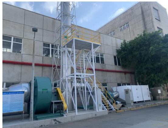
管材押出车间废气处理设施
