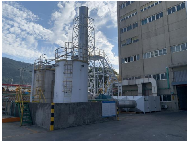
管件射出车间废气处理设施
