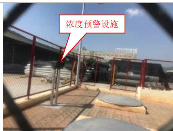
罐区浓度预警设施
