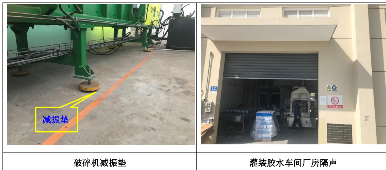
图 4-3 噪声源减振降噪措施现场情况图
